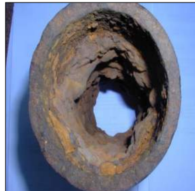
Entartage de canalisation
