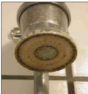
Paume de douche corrodée
